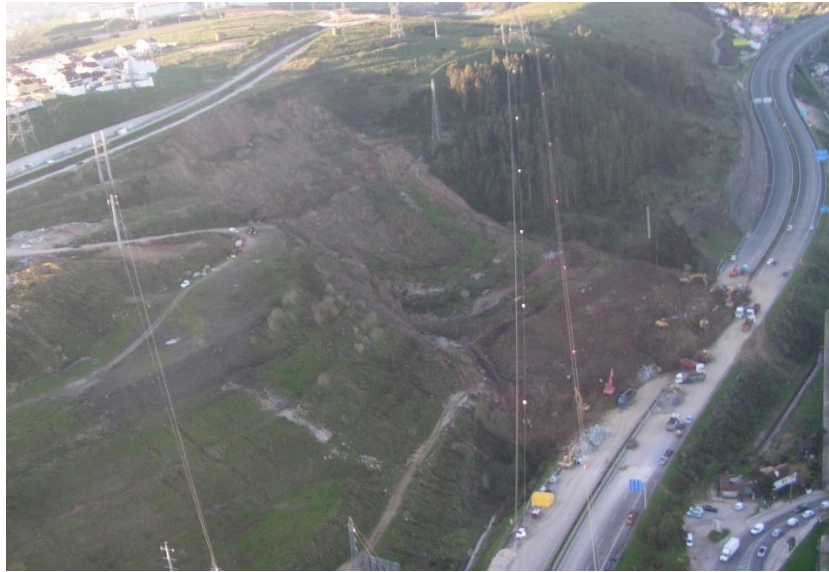
Fig. 18 – Vista aérea del deslizamiento que afectó a la carretera A9-CREL.
